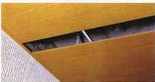
INSTALACIÓN DE FALSO TECHO DE P.V.C. SOBRE PERFIL PRIMARIO CON LAMA REGISTRABLE
